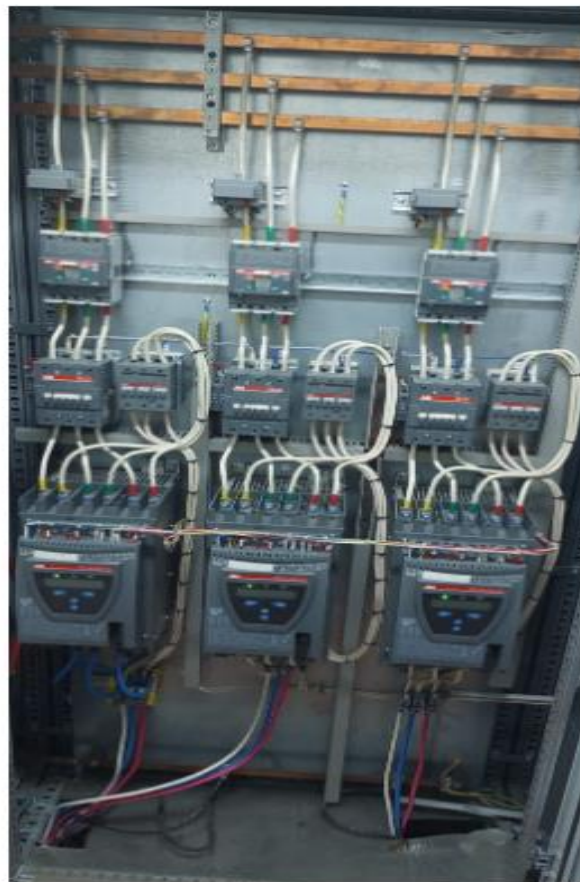
Рис. 2 –Шкаф управления работой насосной станцией
